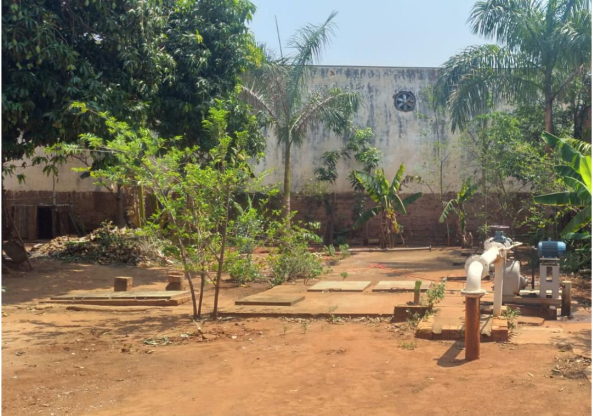
IMAGEM 01 - AO LADO DIREITO DA IMAGEM, A BOMBA QUE PRECISA SER RETIRADA PARA ESTAR SE REALIZANDO A MANUTENÇÃO. AS TAMPAS DE CONCRETOS, MOSTRAM AONDE ESTÃO LOCALIZADOS OS TANQUE DO ESGOTO.
