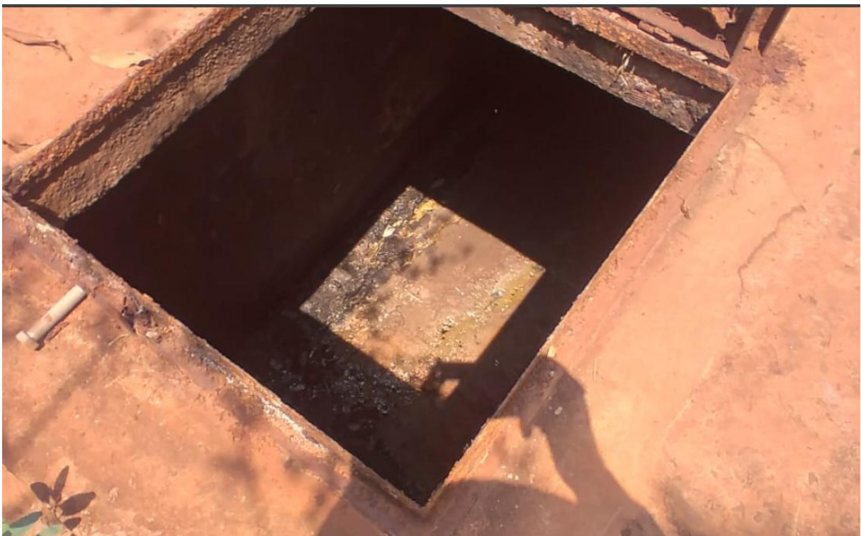
IMAGEM 03 – SITUAÇÃO EM QUE SE ENCONTRA DENTRO DO RESERVATÓRIO, MOSTRANDO QUE A BOMBA QUE ESTÁ PRESENTE NO LOCA, JÁ NÃO CONSEGUE OPERAR COM 100 % DE SUA CAPACIDADE
